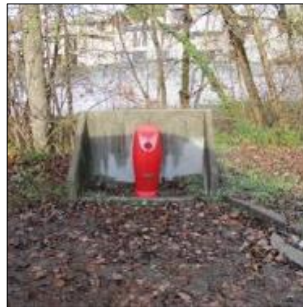
Poteau d'Incendie CO-18 situé à Copponex
